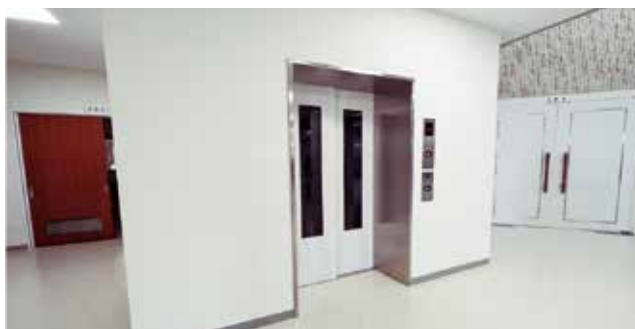
▲小野市民センター大規模改修工事で新しく設置されたエレベーター
